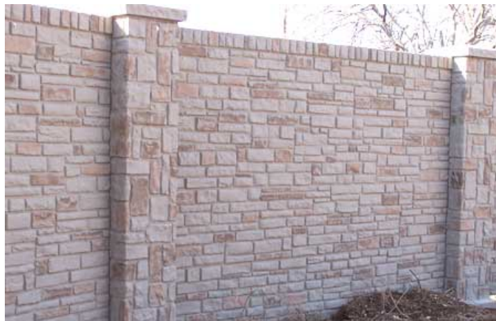
Kuva 6. Makrokuiduilla vahvistettu betoninen kuvioitu aita.
