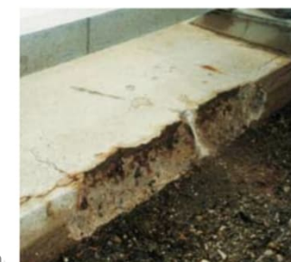
Kuva 1. Korjaamattomat halkeamat edistävät betonin rapautumista ja raudituksen korroosiota ja aiheuttavat jäätymisvaurioita.
