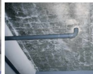
Kuva 1. Betonipeite halkeilee raudituksen korroosion käynnistyttyä.
