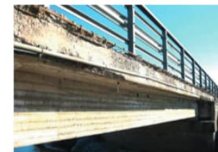
Kuva 1. Vaurioituneen reunakaistan uusiminen reunapalkkina edellyttää aina tartuntoja.
