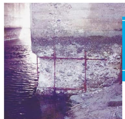
Kuva 1. Laajoja rapautumia on yleensä alusrakenteissa.
