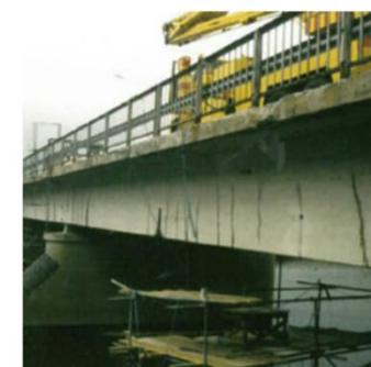
Kuva 1. Vinoa leikkaushalkeamia tukien lähellä ja pystysuoria taivutushalkeamia aukon keskellä.
