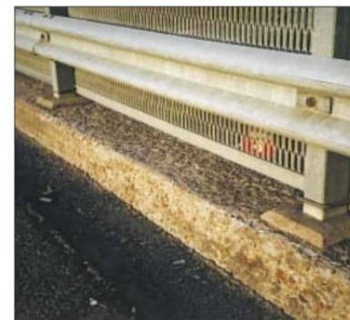
Kuva 1. Talvisuolauksen aiheuttamaa rapautumista reunapalkissa.
