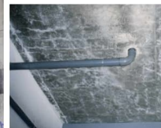
Kuva 1. Betonipeite halkeilee raudituksen korroosion käynnistyttyä.
