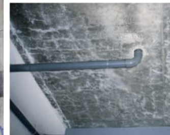
Kuva 1. Betonipeite halkeilee raudituksen korroosion käynnistyttyä.
