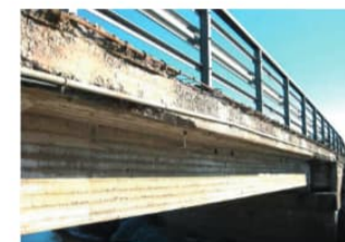
Kuva 1. Vaurioituneen reunakaistan uusiminen reunapalkkina edellyttää aina tartuntoja.
