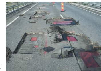
Kuva 1. Kuntolievauriokohdan avara ruutulla sillalla
