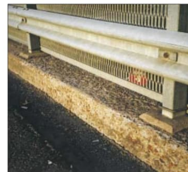
Kuva 1. Talvisuolauksen aiheuttamaa rapautumista reunapalkissa.
