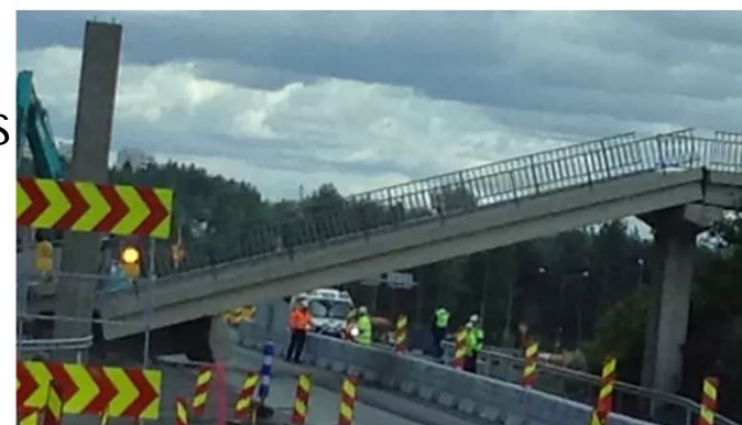
Kevenliikenteen silta romahti yllättäen Mikkelissä – katso kuva
