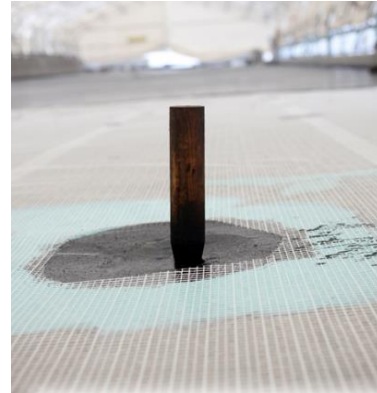
Tippuputken reikä tukittu.
