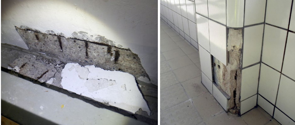
Kuvat 5a ja b. Klorideista aiheutuva korroosio etenee tyypillisesti pitkälle ennen kuin se näkyy silmämääräisesti rakenteen pinnalla. Kuvat Ramboll Finland Oy.
