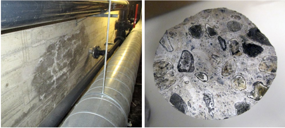
Kuva 6. a) Alkali-kiviainesreaktion aiheuttamaa halkeilua altaan reunassa. b) Kiviaineksessa näkyviä kehärakenteita betonilieriön katkaisupinnalla. Kuvat Ramboll Finland Oy.
