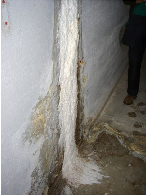
Kuva 4. Aktiivisesti vuotava halkeama altaan seinässä. Vuotoveden kuivuessa haihtumisyöhykkeelle muodostuu suolakiteytymiä. Kuva Ramboll Finland Oy.
